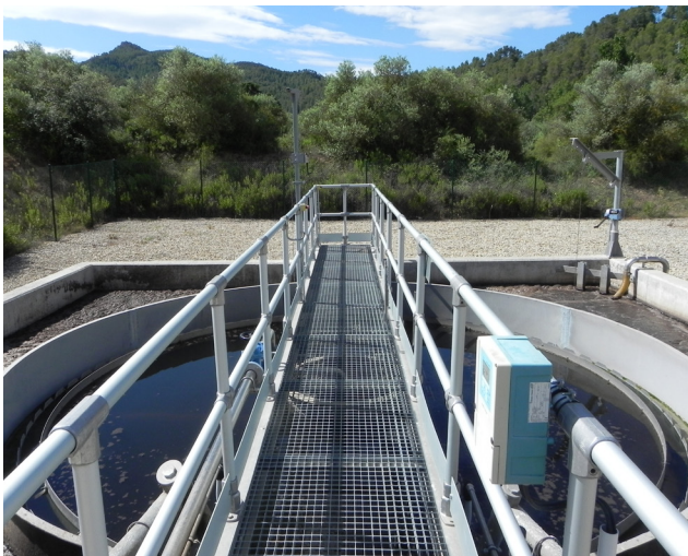
Depuradora de Capçanes
